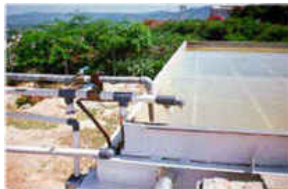
Fig. 3. Detalle de las tuberías de llenado del filtro óptico líquido.
