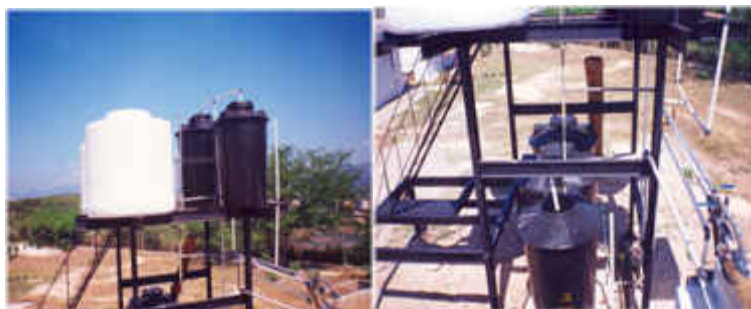
Fig. 4. Estructura de los tanques que suministran agua y solución al filtro.
