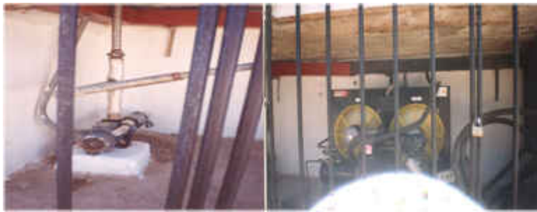
Fig. 7. Bomba de agua fría y unidad condensadora.
