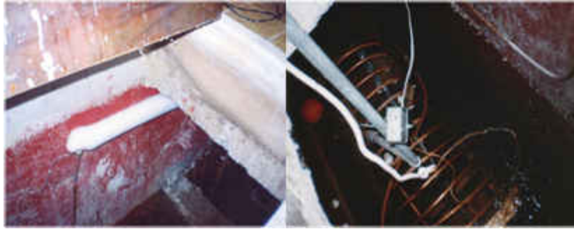
Fig. 6. Tanque de agua fría.
