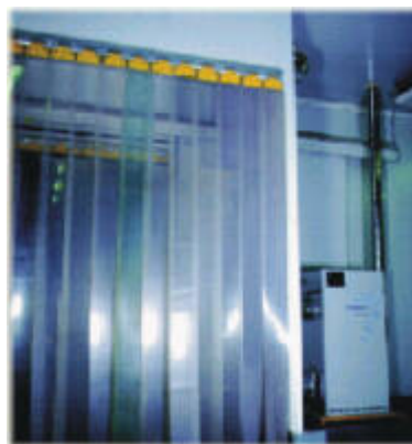
Fig. 4. Cámara de congelados con un deshumidificador MUNTERS
