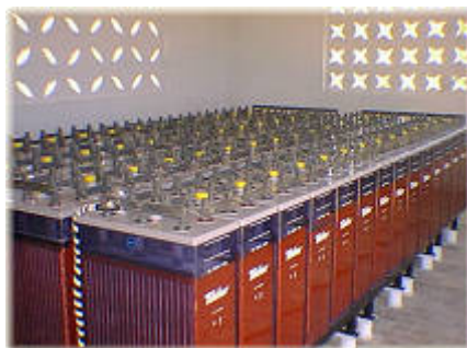
Fig. 2. Banco de baterías del SFVA del poblado de Santamaría del Loreto.
