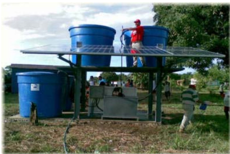
Fig. 32. Sistemas de potabilizadoras de agua y de bombeo.
