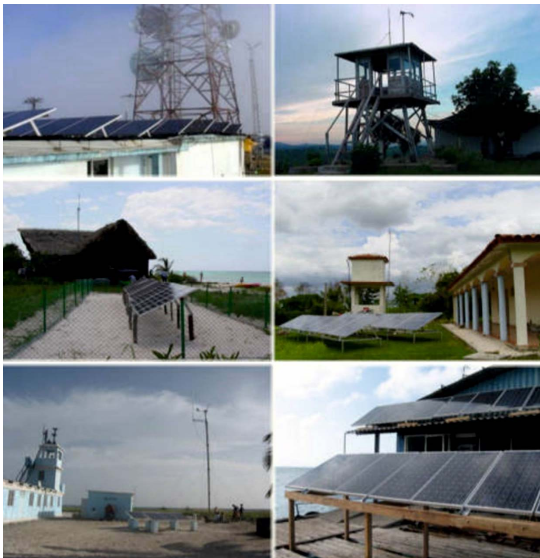
Figs. 18-23. Ejemplos de sistemas instalados.
