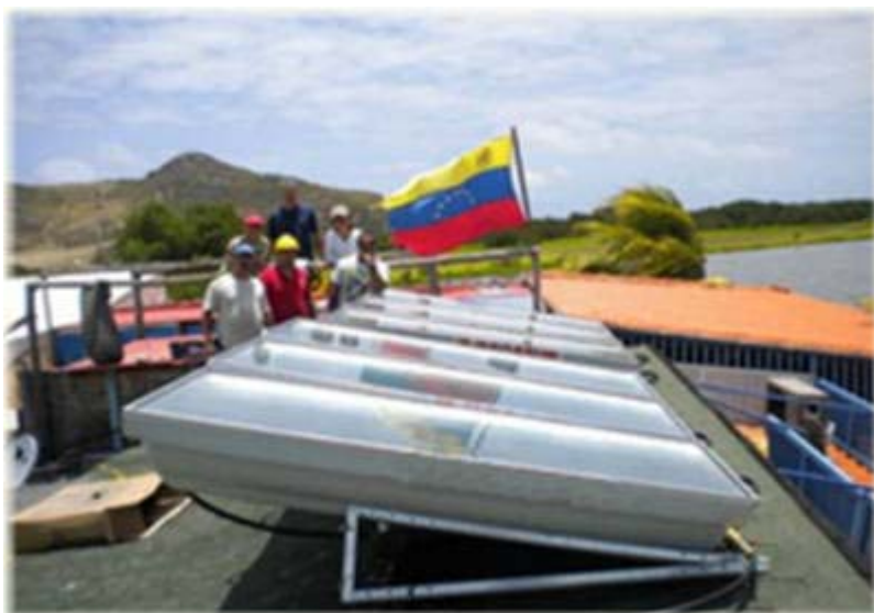
Fig. 38. Calentadores solares instalados en Venezuela.
