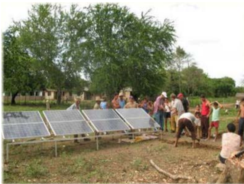
Fig. 17. Sistemas de bombeo de agua.
