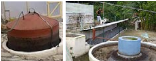
Fig. 3. Tipología de los biodigestores instalados en el polígono Los Seborucos.
