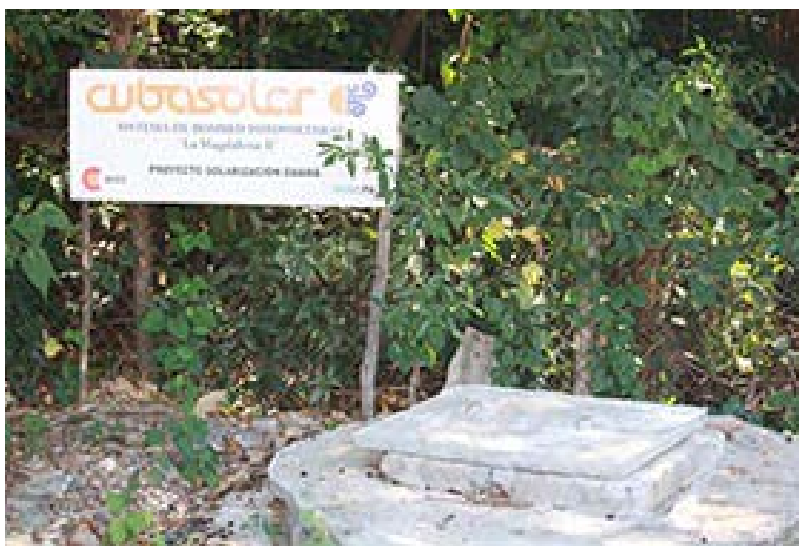
Fig. 2 Bombeo fotovoltaico en La Magdalena.
