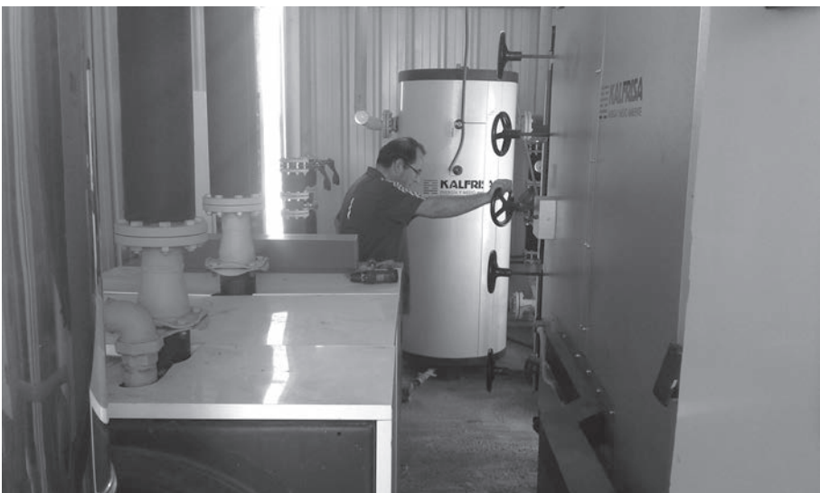
Fig. 3. Sala de caldera.
