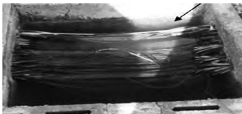
Fig. 2. Aguas en los registros y mala organización del cableado fotovoltaico.
