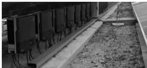
Fig. 5. Concentración de los inversores y el panel concentrador.
