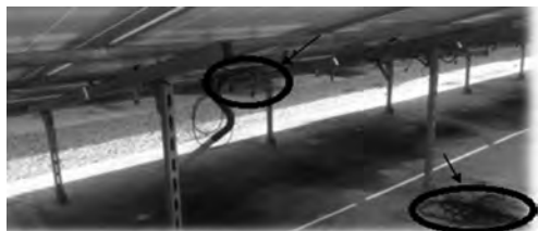
Fig. 3. Mala organización del cableado fotovoltaico y el área sucia.
