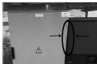
Fig. 4. Colocación inadecuada del inversor (a la derecha) y el panel concentrador (a la izquierda).
