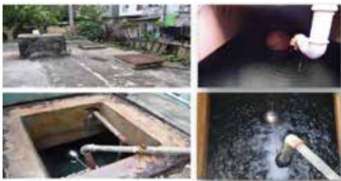
Fig. 1. Fotos de flotantes Instalados.
