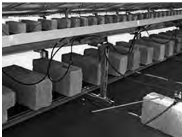
Fig. 7. Aterramiento de la estructura de los módulos fotovoltaicos.
