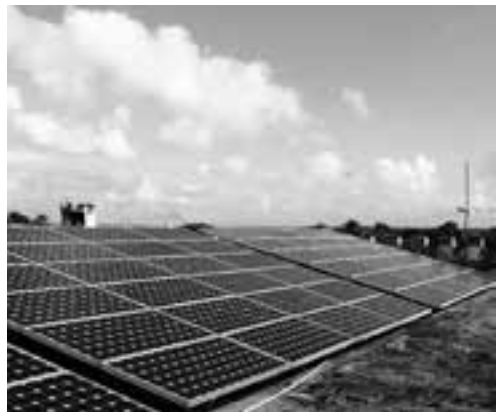
Fig. 1. Instalación solar fotovoltaica.
