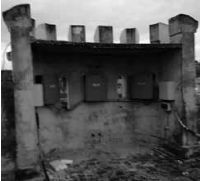
Fig. 2. Caseta de los inversores.
