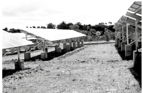
Fig.1. Instalación solar fotovoltaica.
