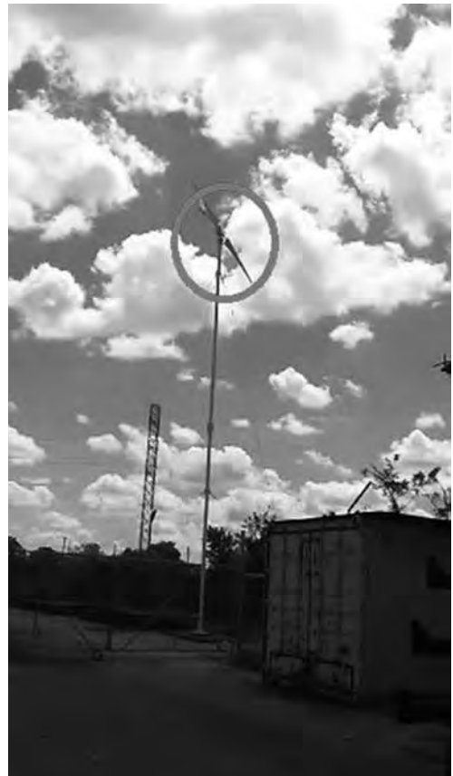
Fig. 12. Aerogenerador Tornado T1.5kW en el campo de pruebas.
