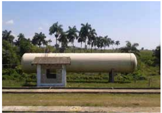
Fig. 2. Depósito del biogás.
