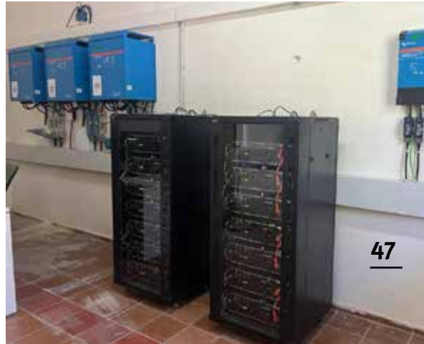
Banco de baterías de litio.
