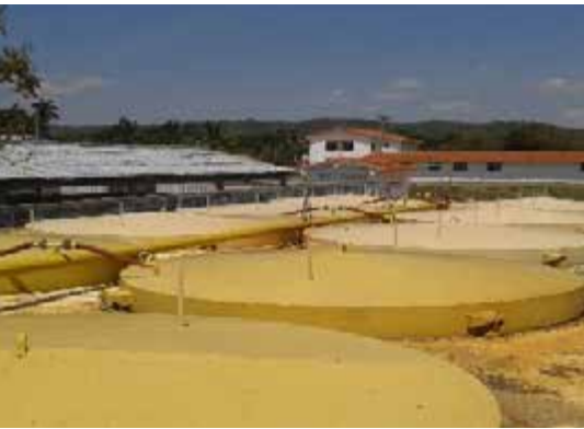
Fig. 1. Biodigestor de cúpula fija.
