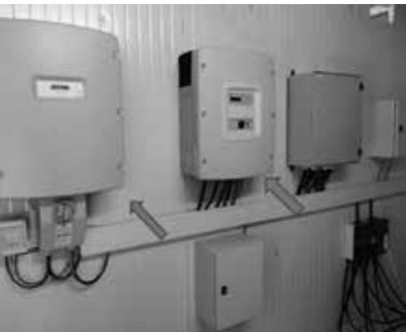
Fig.4. Inversores de la instalación.
