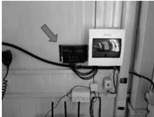
Fig.5. Regulador fotovoltaico conectado al sistema de comunicación.
