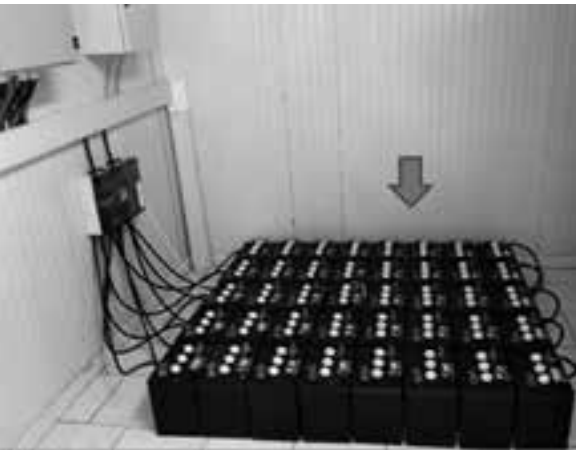
Fig.3. Banco de baterías.
