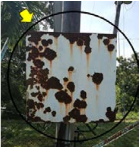
Fig. 3. Deterioro de la pizarra eléctrica general de distribución.
