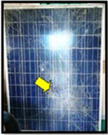
Fig. 2. Módulo solar fotovoltaico dañado.
