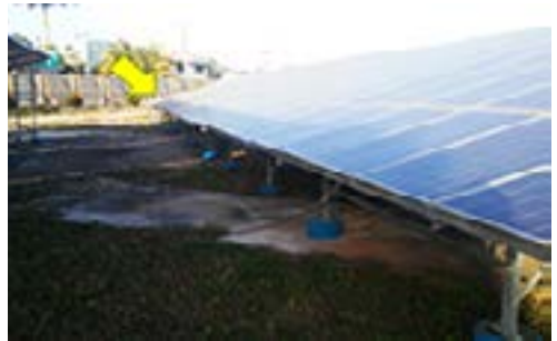
Fig. 8. Sombra en los módulos solares fotovoltaicos.
