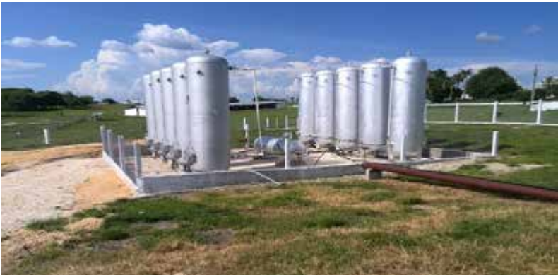
Fig. 2. Depósito de almacenamiento.
