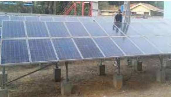
Fig. 1. Instalación solar fotovoltaica.
