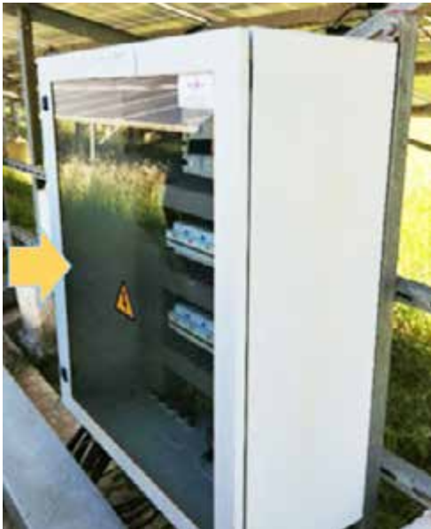
Fig. 7. Pizarra eléctrica general de distribución.
