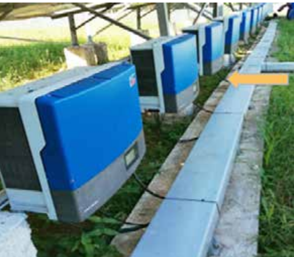
Fig. 2. Inversores trifásicos de tipo conexión a red.
